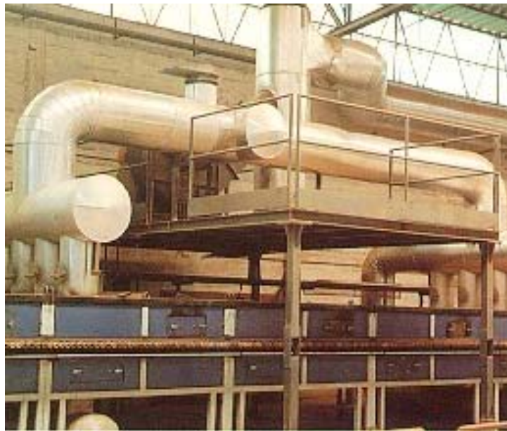
Fig. 11 - Condotto orizzontale per l'adduzione dei gas allo scambiatore presso la Mosaicos Ceramicos
